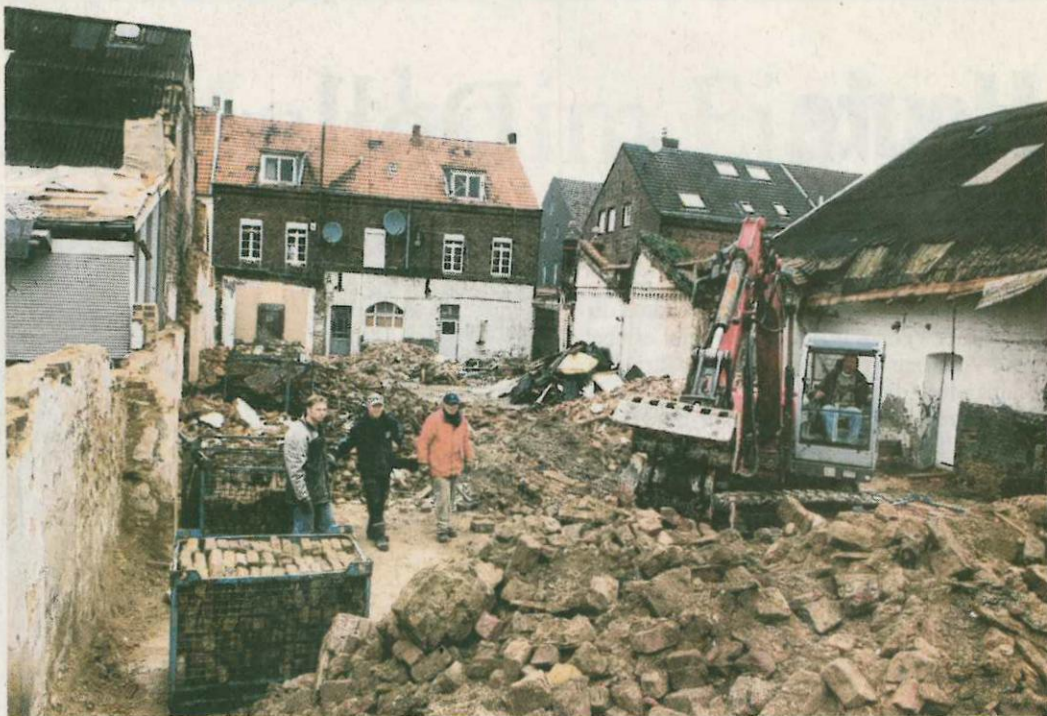
Eine Ära geht zu Ende: Von der alten Dampfschreinerei an der Brauereistraße ist nichts mehr übrig.
